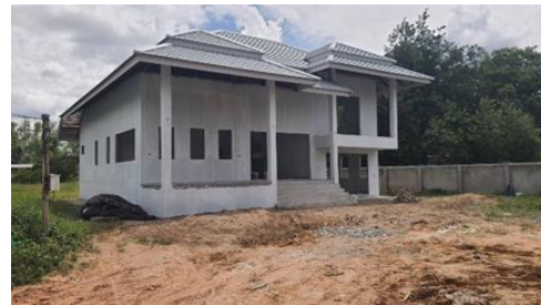
รูปที่ 2 การก่อสร้างผนังอิฐมวลเบา หลังนำแนวคิดลีนมาปรับใช้
