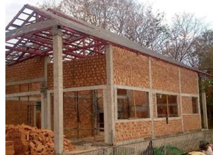
รูปที่ 1 การก่อผนังอิฐมวลเบาบ้านสันผีเสื้อ ก่อนนำแนวคิดลีนมาปรับใช้
