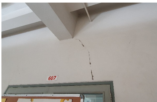
รูปที่ 11 บริเวณที่เกิดความเสียหายเนื่องจากการต่อเติมโครงสร้าง
