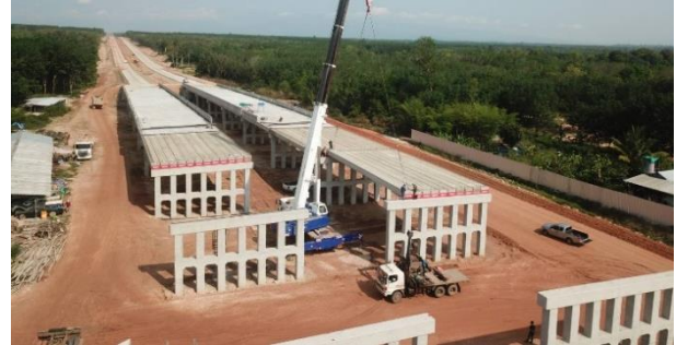
ค. บริเวณที่มีการทำงานในที่สูงบริเวณสะพานข้ามทางแยก
