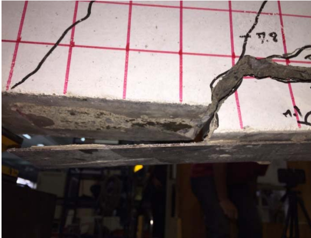
รูปที่ 19 การหลุดล่อนของแผ่นเหล็กในคานเสริมกำลัง SB-1D-3mm
