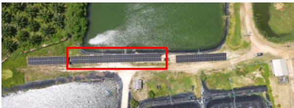
รูปที่ 3 บริเวณที่มีการติดตั้งโครงสร้างผิดทำให้ต้องรื้อจุดติดตั้งที่ฟาร์ม A
